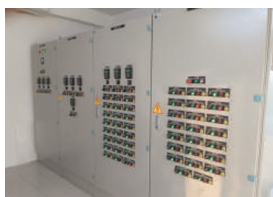
Nhà máy xử lý nước thải KCN Đồng Văn IV
