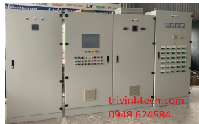
Tủ điều hệ thống xử lý rác thải sinh hoạt khu liên hợp
