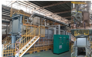
Tủ điện điều khiển lò xử lý nhiệt Khách hàng nhà sx xe máy Nhật bản
