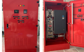
Tủ điều điều khiển bơm PCCC, quạt hút khói, van MFD..
